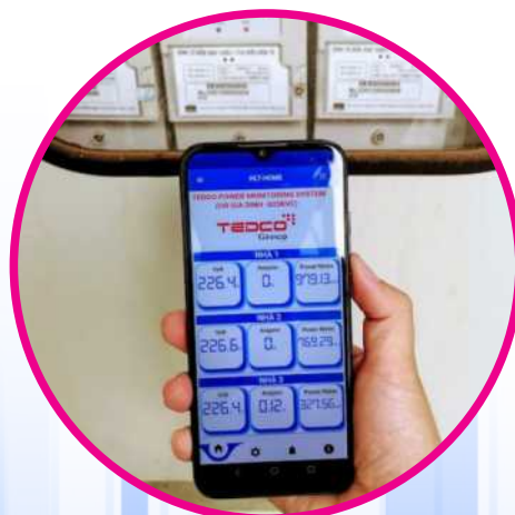
Tủ điện kiểm soát điện năng IoT
